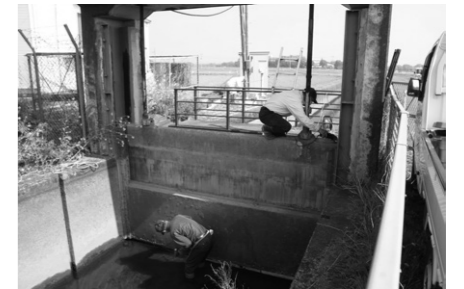
古川に設置された電動式の堰
