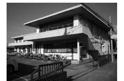
老朽化著しい山田市民センター
