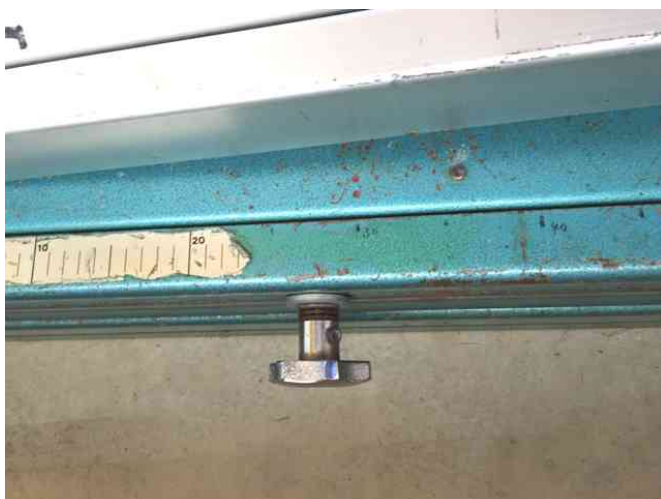
本番用の支柱の土台のネジが壊れています。
